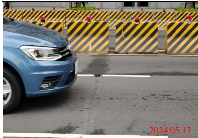
巡查日期地點：113.05.13/ Y23車站 照片說明：南側道路坑洞
