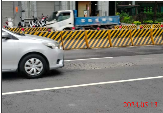
巡查日期地點：113.05.13/ Y23車站 照片說明：南側道路龜裂
